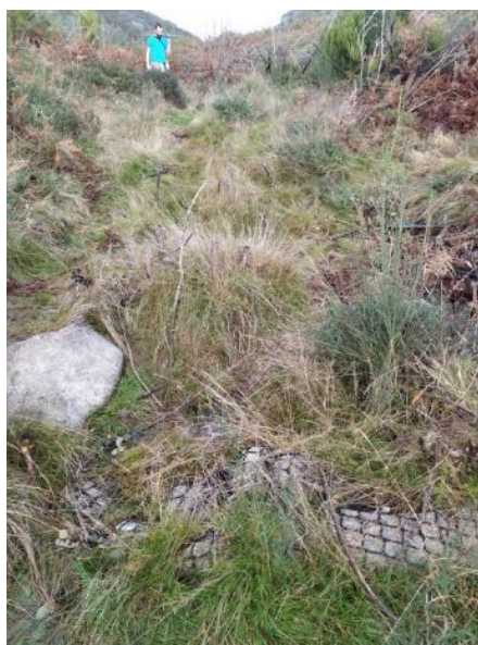
Figura 1. Barreira com pedras (gabião) já coberta por um manto de gramíneas (foto de 2020).
